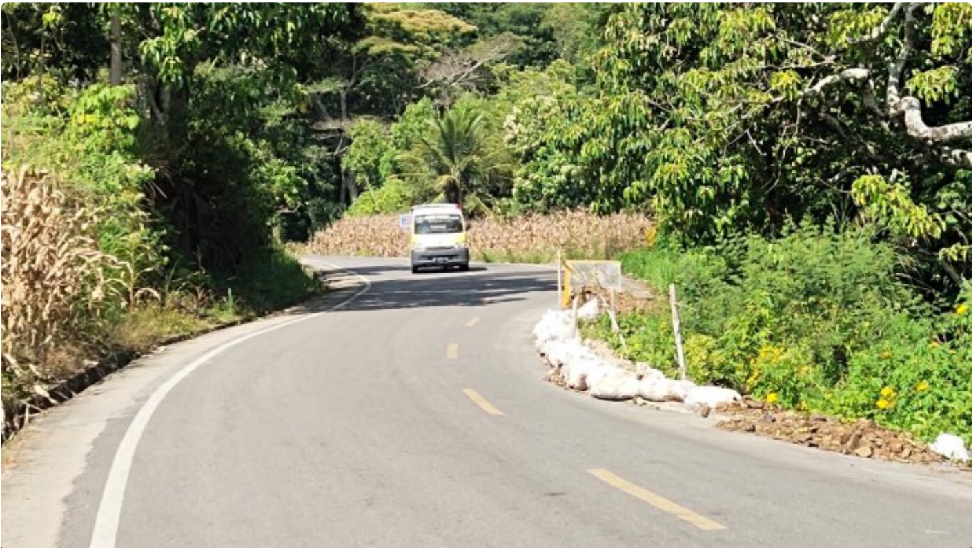
Bdan Jalan Amblas di Jalinsum Tomok-Pangururan Desa Marlumba Kecamatan Simanindo
